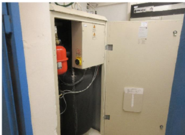
Kylanläggning för kyla av tilluft, del av lokalerna
