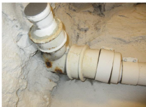
Delvis äldre avloppsrör i källaren
