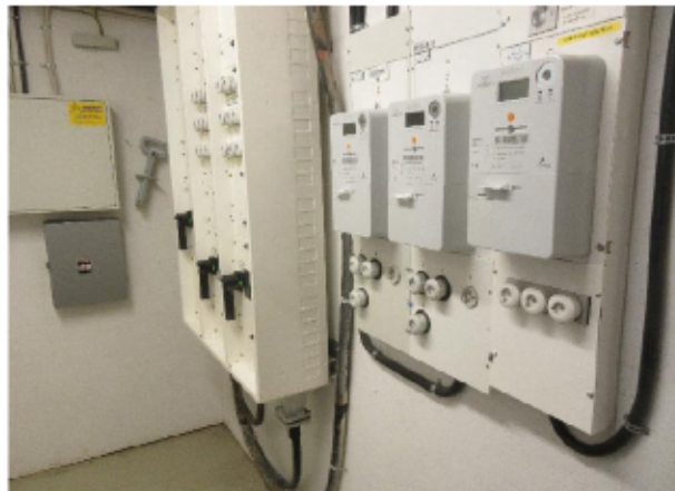
Elektriska installationer från 2000
