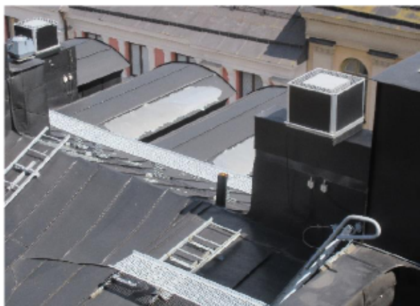
Färgen flagar lokalt på plåttaket
