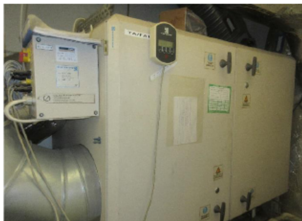
Det mekaniska till- och frånluftsaggregatet.
