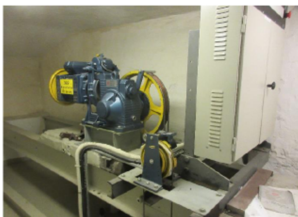
En av hissmaskinerna
