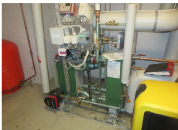
Undercentral för fjärrvärme
