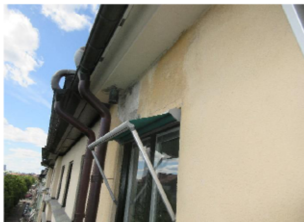
Tecken på läckage från takbrunn
