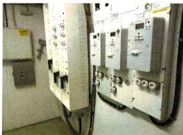
Elektriska installationer från 2000
