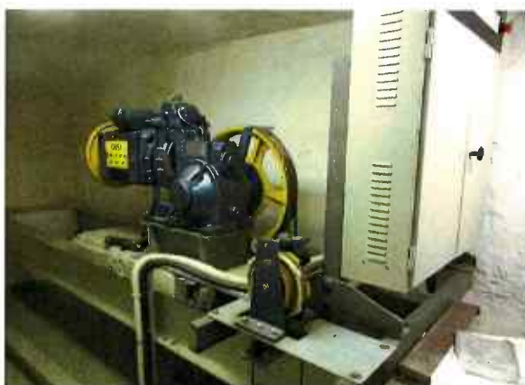
En av hissmaskinerna
