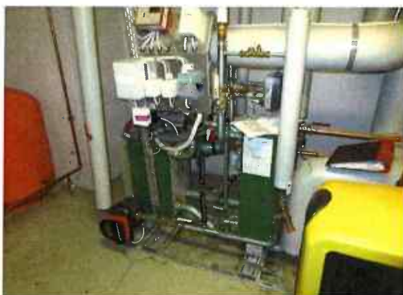
Undercentral för fjärrvärme
