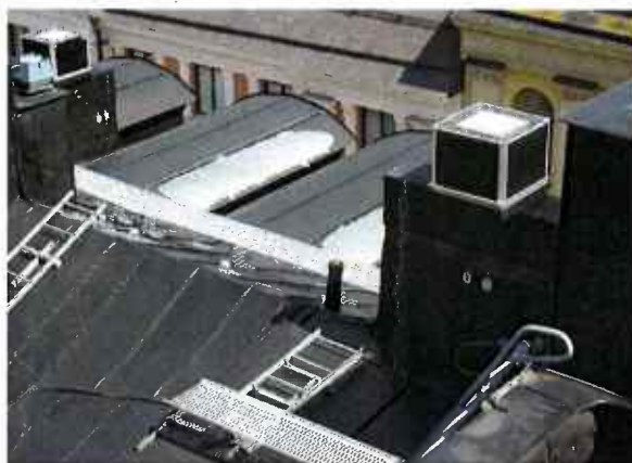
Färgen flagar lokalt på plåttaket
