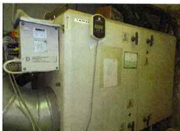
Det mekaniska till- och frånluftsaggregatet.
