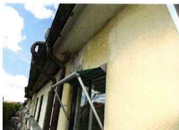
Tecken på läckage från takbrunn
