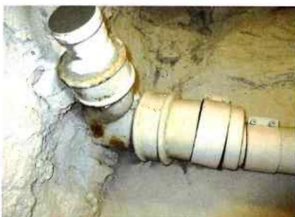
Delvis äldre avloppsrör i källaren
